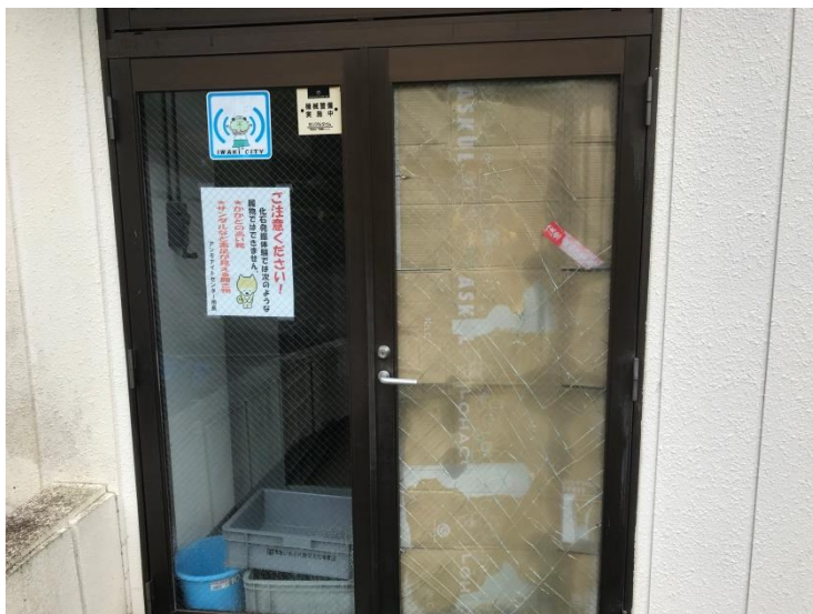
図5. 破損した通用口
